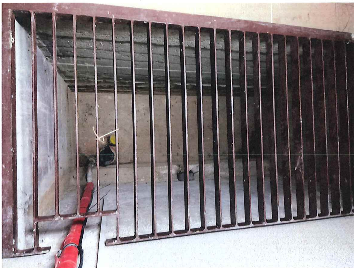
Fot. 21. Studzienka przy schodach w kondygnacji piwnic – widoczna pompa oraz wlot rury z podszybia windy
