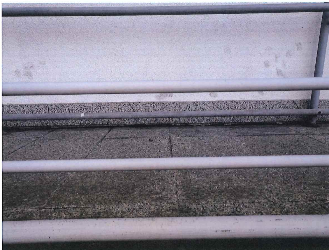
Fot. 18. Nieszczelność na styku cokolika i pochylni – rejon wejścia głównego do budynku
