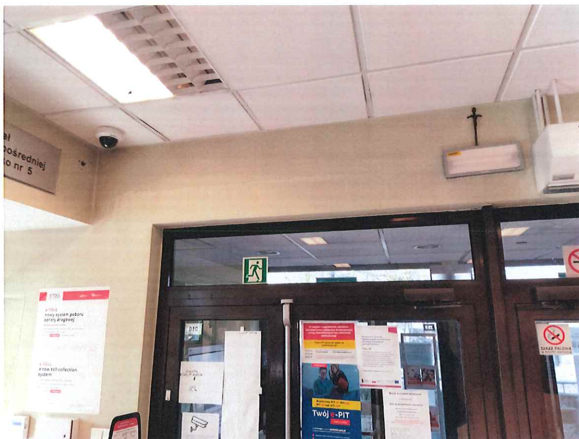
Fot. 31. Zarysowanie poziome nad drzwiami wejścia głównego do budynku - widok z sali obsługi
