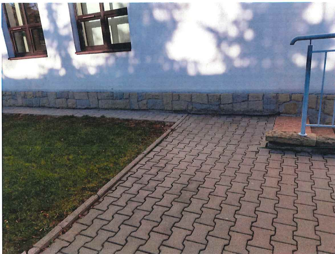
Fot. 15. Osiadania opaski i chodnika z kostki brukowej przy schodach zewn. - elewacja południowa
