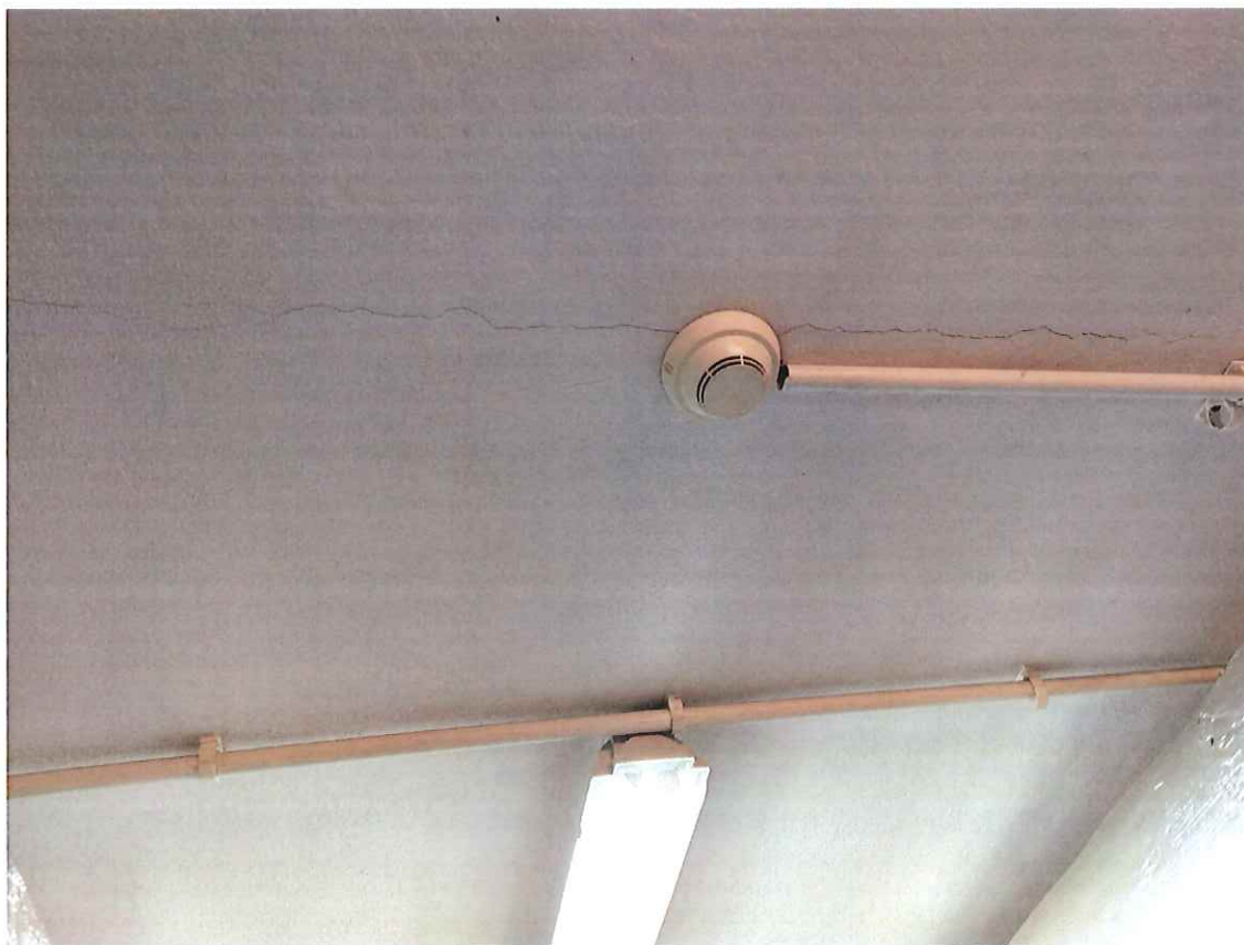
Fot. 26. Zarysowanie stropu w pomieszczeniu P07
