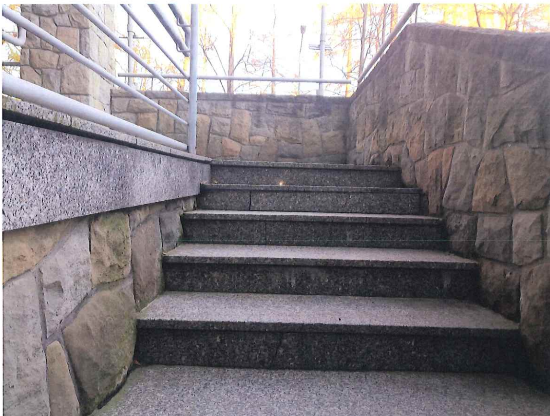
Fot. 17. Popękane podstopnice w schodach przy wejściu głównym do budynku
