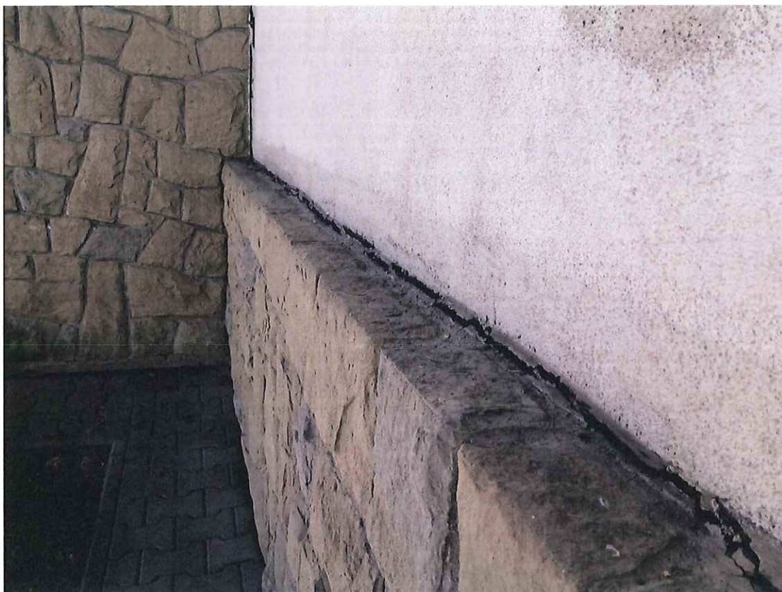
Fot. 19. Zarysowanie na połączeniu okładziny kamiennej i izolacji termicznej - elewacja wschodnia
