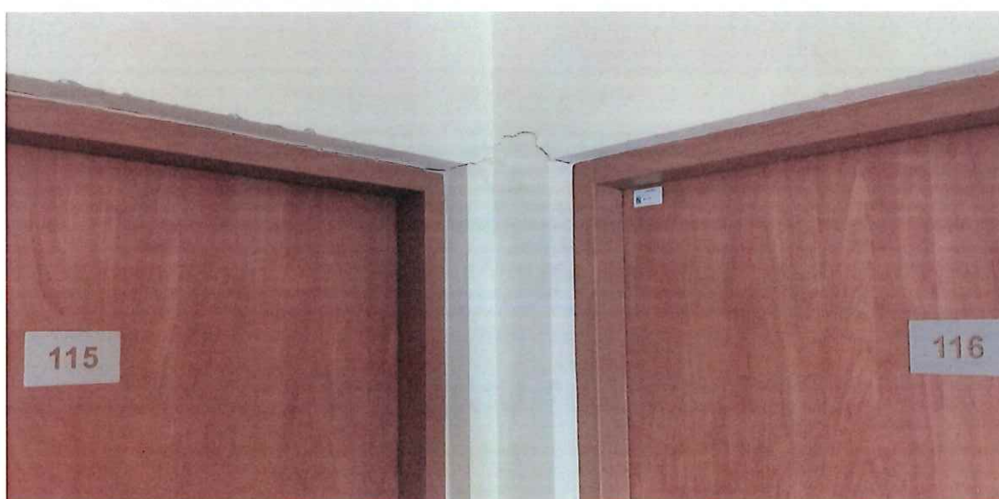
Fot. 38. Zarysowanie ściany pomiędzy pomieszczeniami P115 i P116
