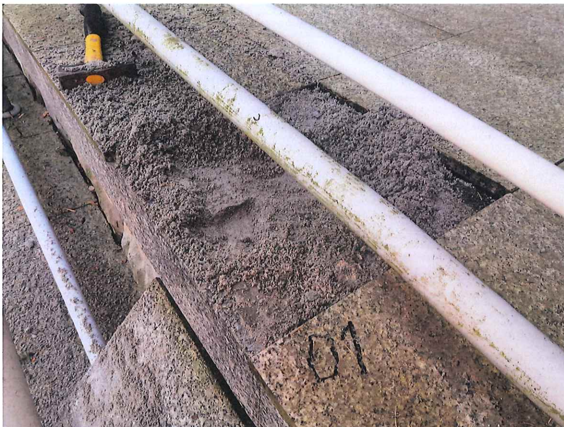
Fot. 5. Odkrywka O1 - uszkodzenia płytek na pochylni
