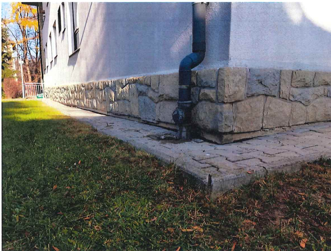
Fot. 9. Efekty osiadania opaski z kostki brukowej wzdłuż elewacji zachodniej i południowej (w narożu osiadanie około 10 cm)
