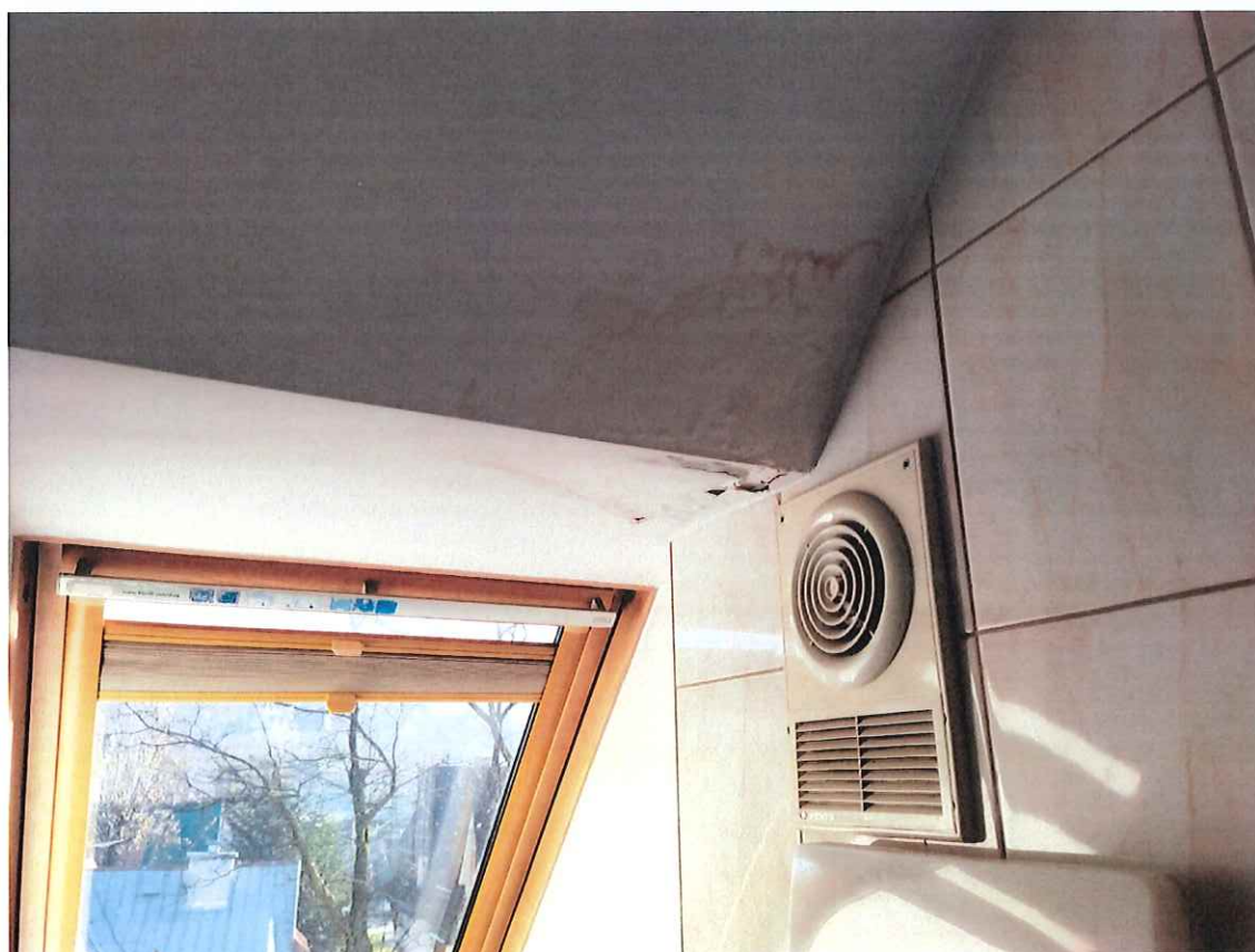
Fot. 48. Zawilgocenie zabudowy G-K w łazience apartamentu A1
