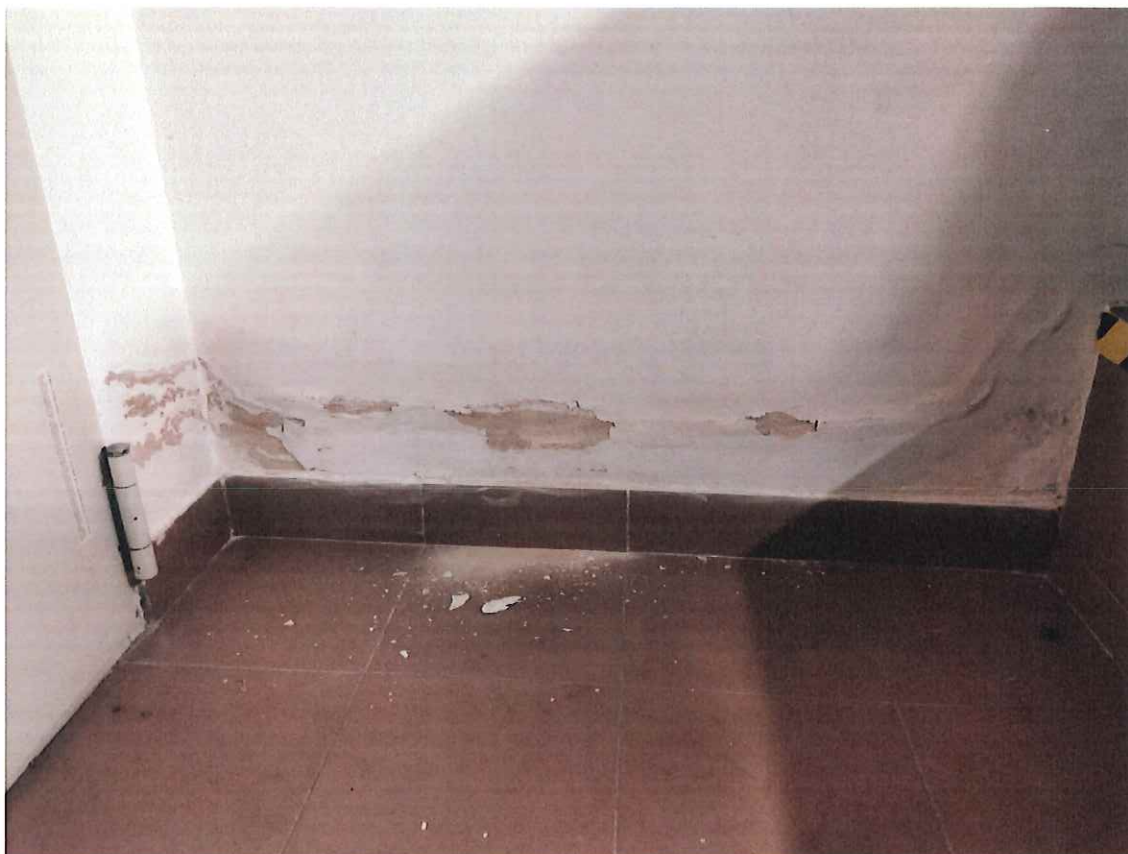
Fot. 23. Efekty zawilgoczeń ścian piwnicy w pomieszczeniu P05
