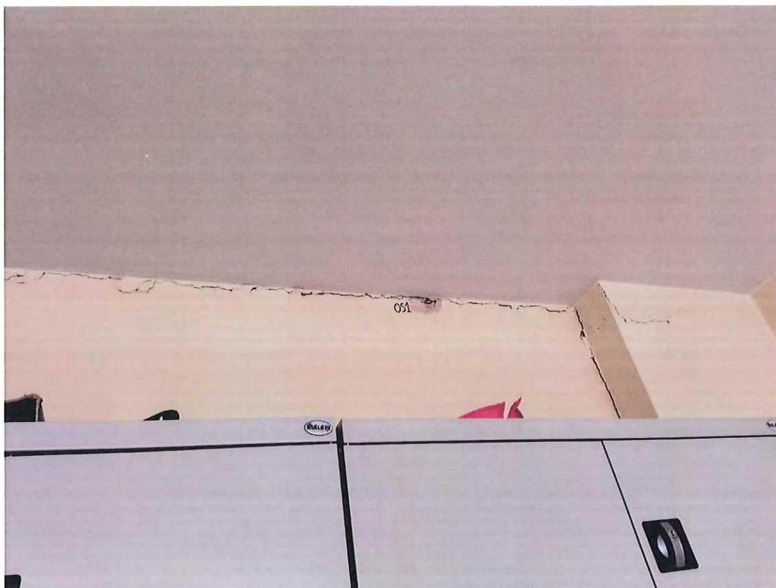
Fot. 41. Odkrywka OS1 oraz zarysowanie ściany w pomieszczeniu P120
