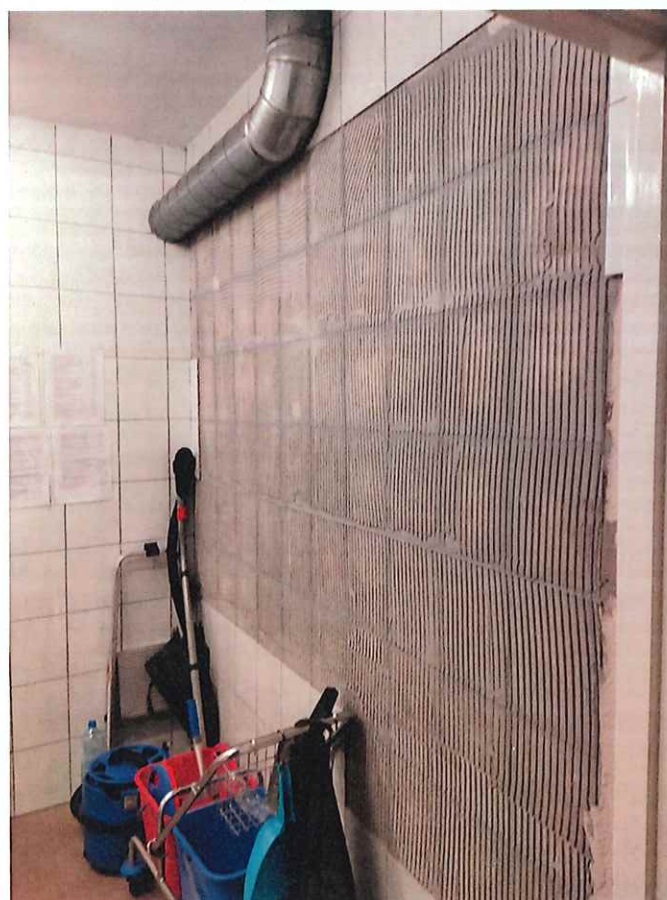
Fot. 30. Odpadnięte płytki na ścianie pomieszczenia P12
