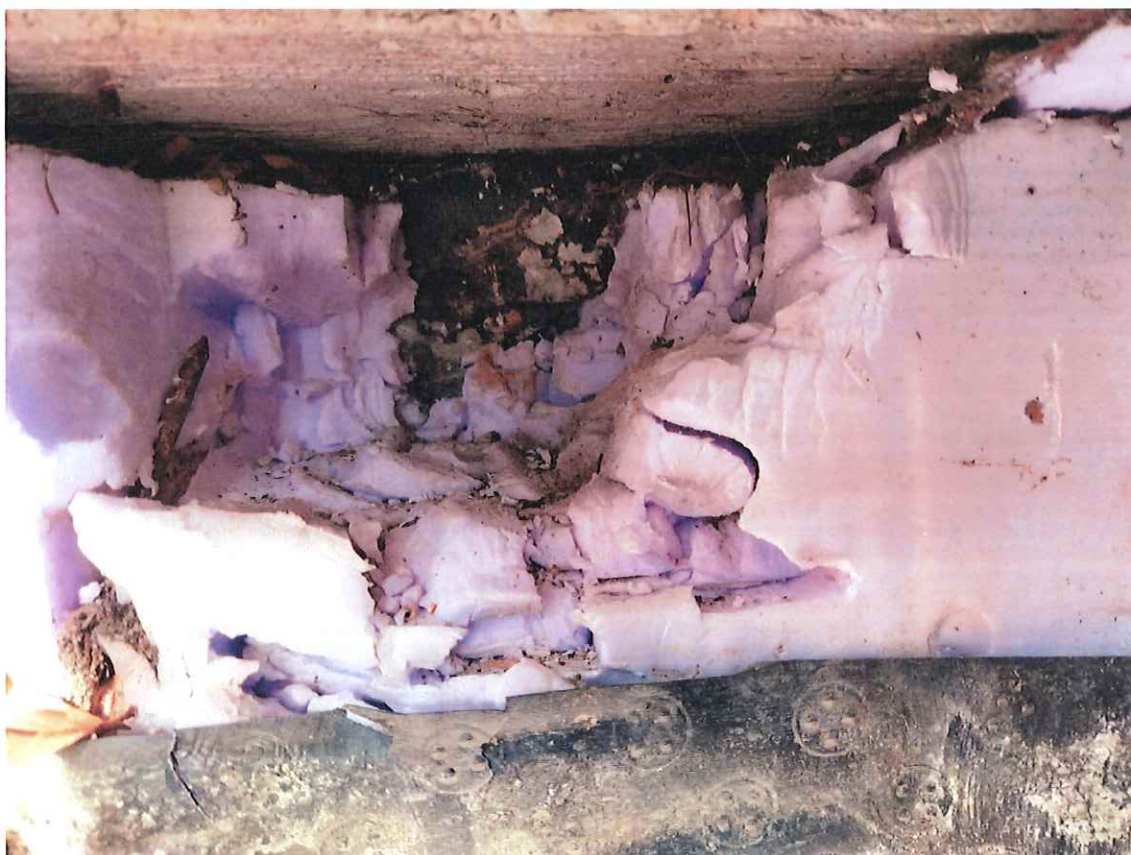
Fot. 12. Odkrywka O4 – nieszczelna izolacja na ścianie
