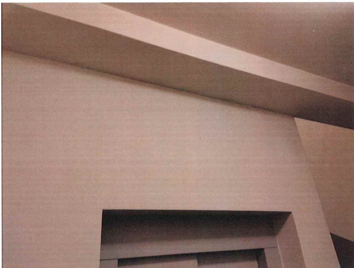
Fot. 53. Zarysowanie nad drzwiami szybu windowego – II piętro
