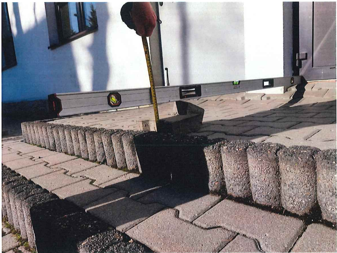
Fot. 13. Osiadania schodów z kostki brukowej (około 12 cm)
