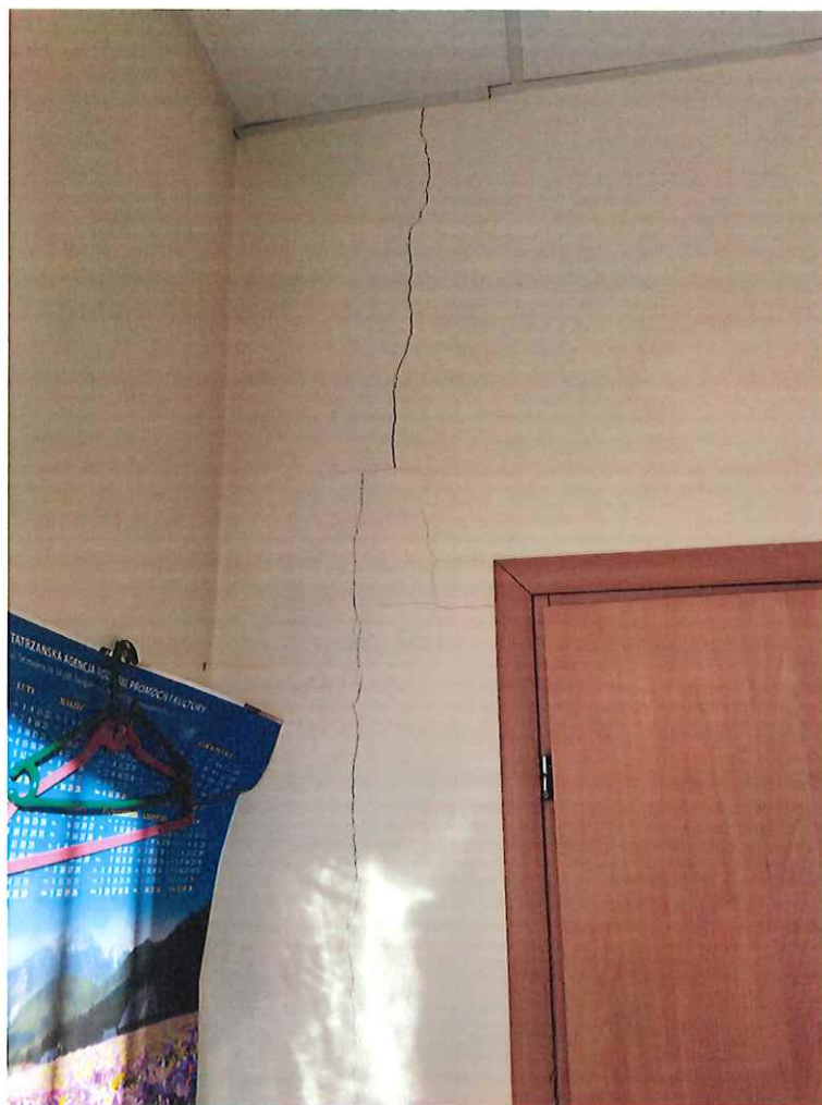
Fot. 35. Zarysowanie ściany w pomieszczeniu P004 (rozwartość rysy 1,2mm)
