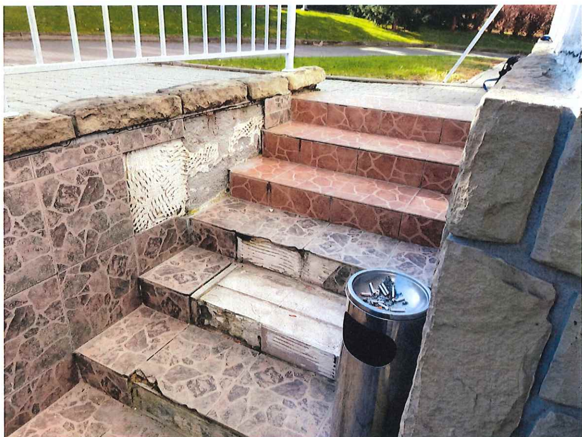
Fot. 14. Uszkodzenia schodów zewnętrznych w elewacji południowej. Odkrywką O5 – uszkodzenia płytek na ścianie oporowej przy schodach
