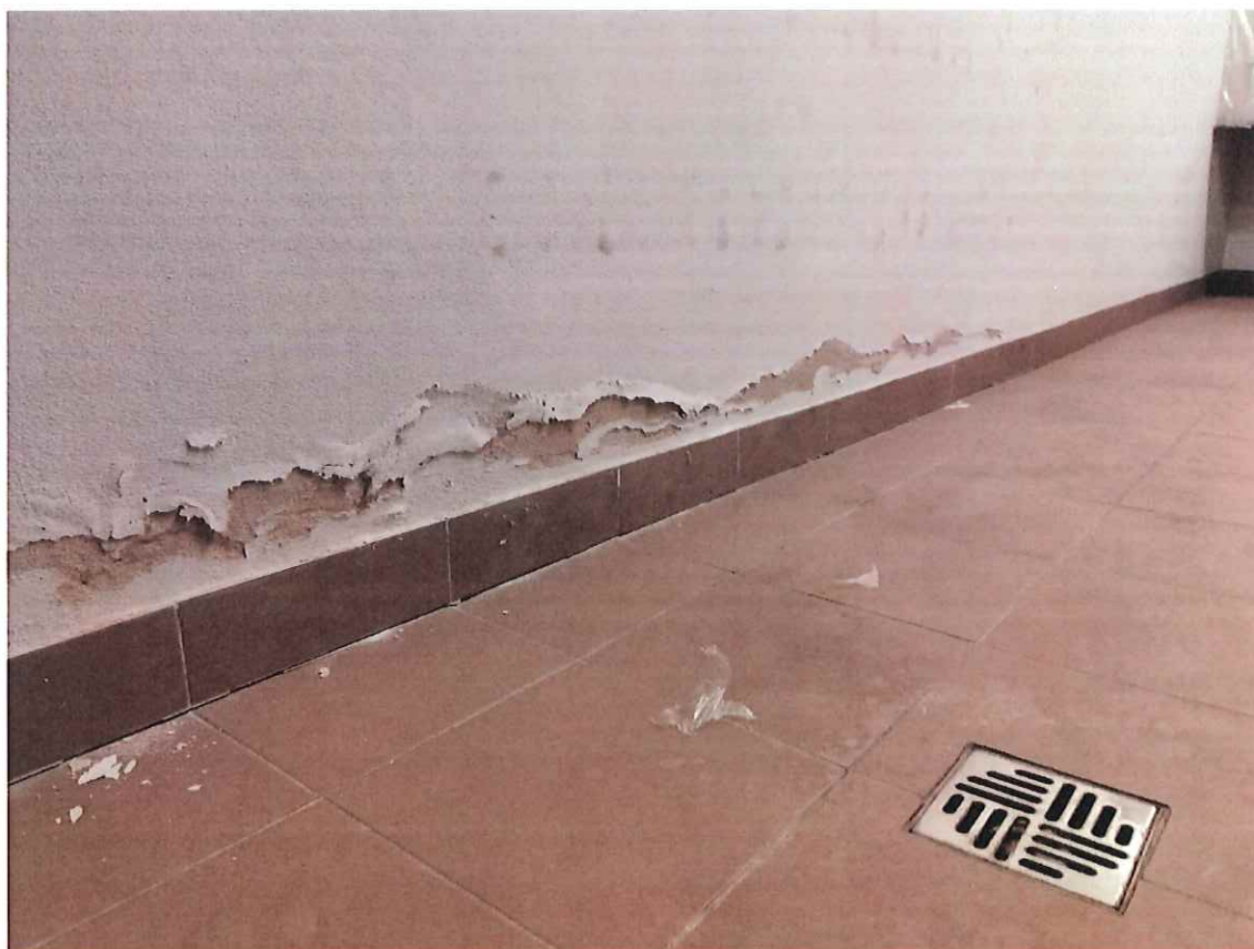
Fot. 22. Efekty zawilgoceń ścian piwnicy w pomieszczeniu P03 oraz odspojenie posadzki z płytek od cokolika
