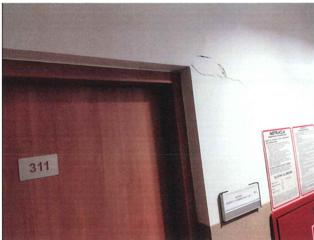
Fot. 49. Zarysowanie przy drzwiach pomieszczenia P311
