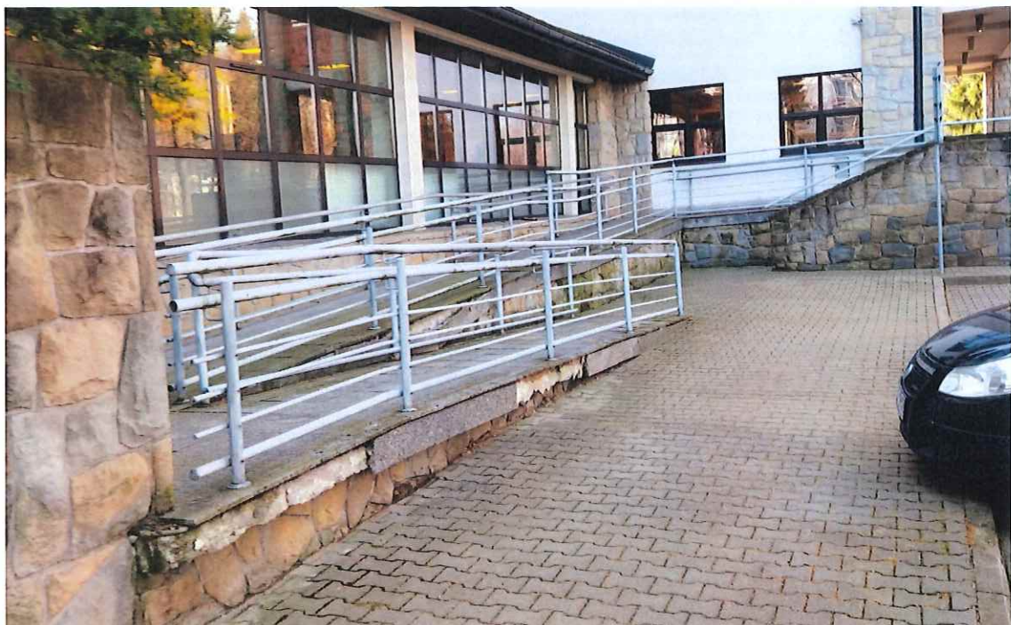
Fot. 4. Uszkodzenia pochylni
