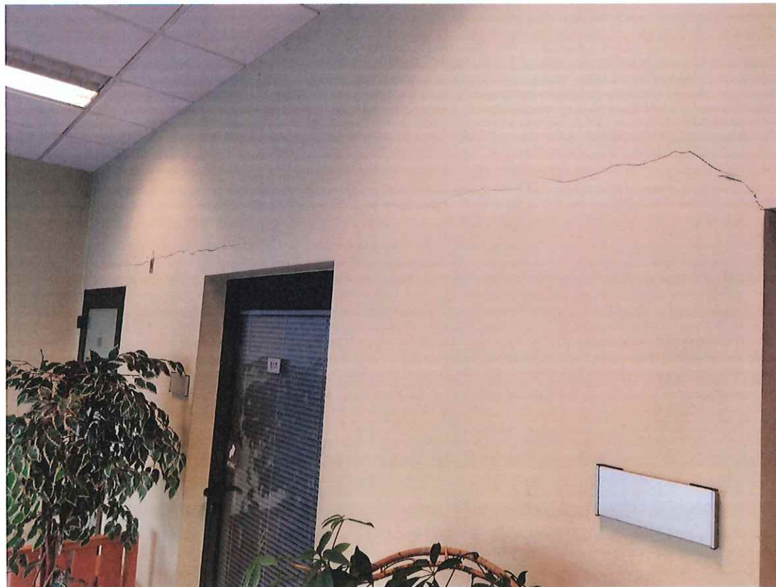
Fot. 32. Zarysowanie poziome nad drzwiami do pomieszczeń P015,P017 oraz korytarza P018 (parter)
