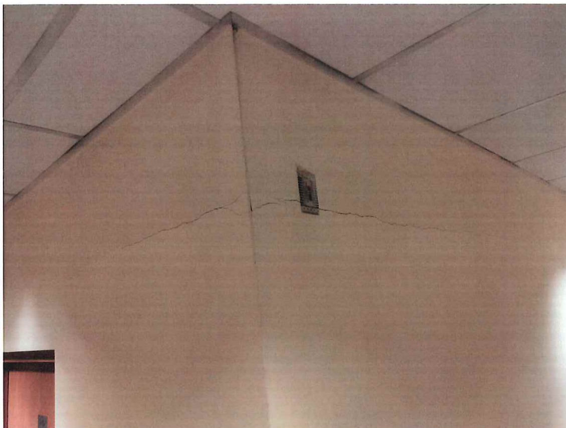
Fot. 47. Zarysowanie ścian pomieszczenia P212 od strony korytarza (rysa 1,3 mm)
