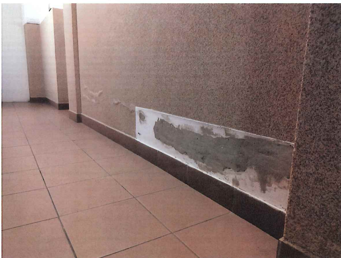
Fot. 24. Powierzchniowa „naprawa” ścian korytarza piwnicy w osi D oraz widoczne ślady wcześniejszych zawilgoczeń
