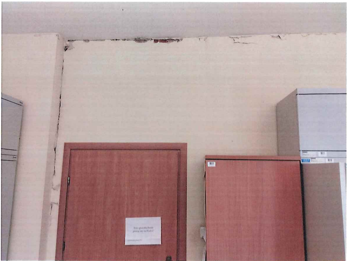
Fot. 43. Zarysowanie ściany w pomieszczeniu P222
