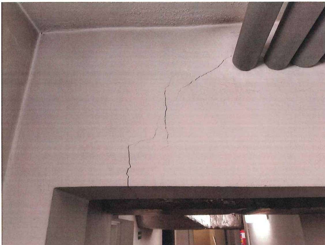
Fot. 27. Zarysowanie nadproża w korytarzu piwnicy (w osi 4)
