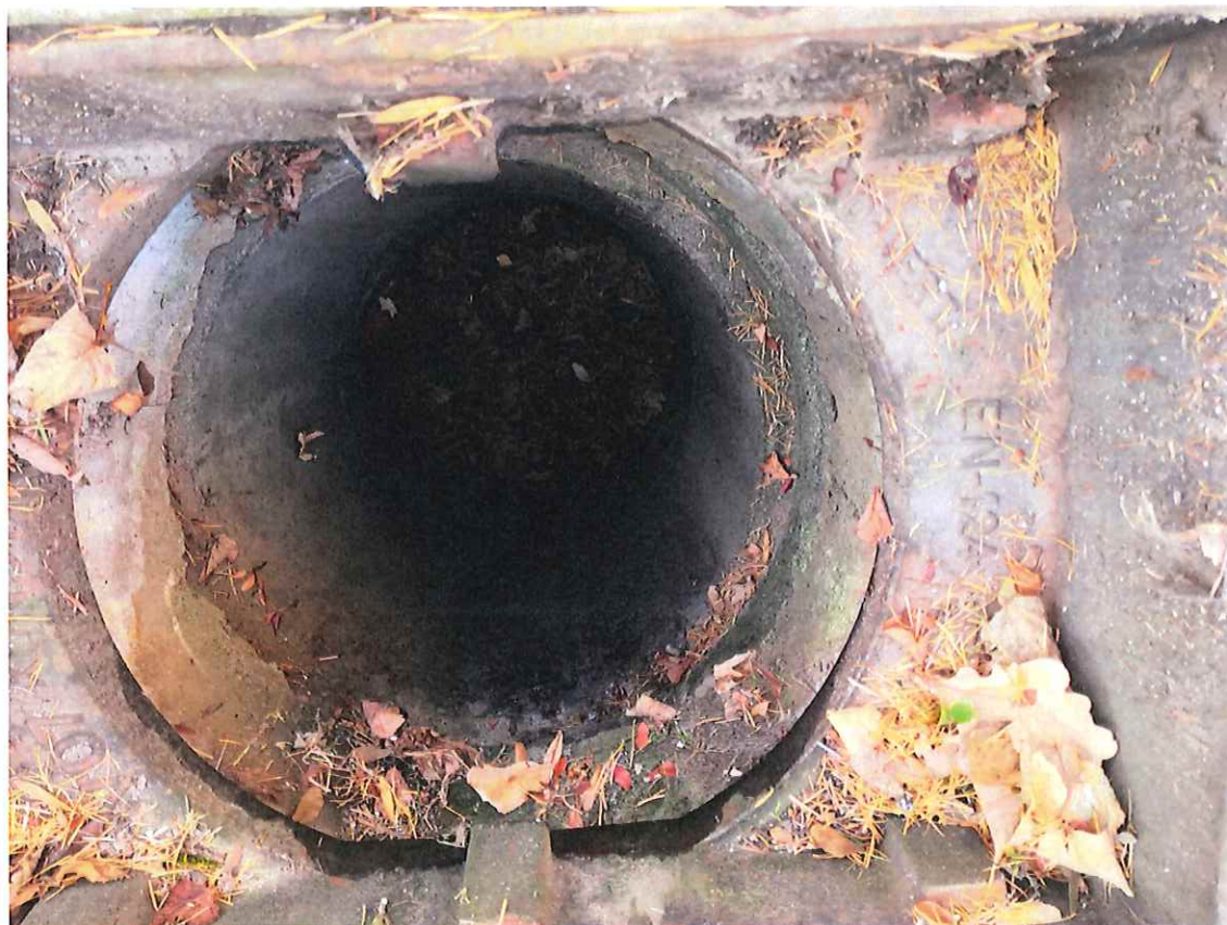
Fot. 56. Zanieczyszczona warstwą liści i błota studzienka kanalizacji deszczowej
