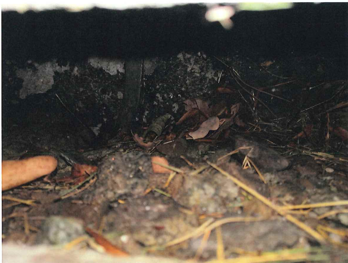
Fot. 55. Brak izolacji termicznej ściany piwnicy, nieszczelna izolacja przeciwwilgociowa
