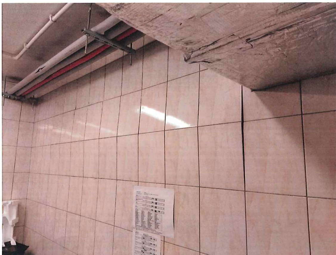
Fot. 29. Odspojenie płytek na ścianie pomieszczenia P09
