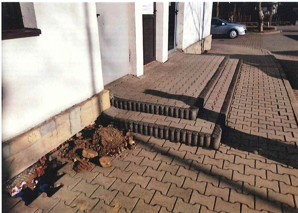
Fot. 10. Osiadania schodów z kostki brukowej i chodnika oraz lokalizacja odkrywki O4
